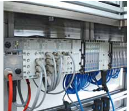
Die Ansteuerung der gesamten Pneumatik übernimmt eine CPX-MPA-Ventilinselkombination.
