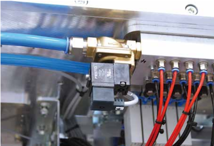
Prozessventile vom Typ MN1H sorgen für die Kühlluft auf den Schweißeinheiten.
